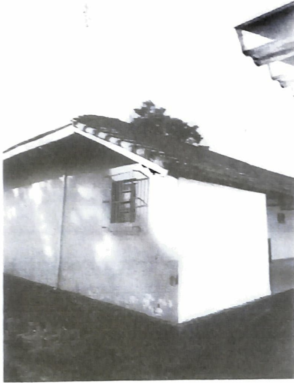
Figura 10 - Parede manchada pela infiltração de água da chuva pela cumeeira
