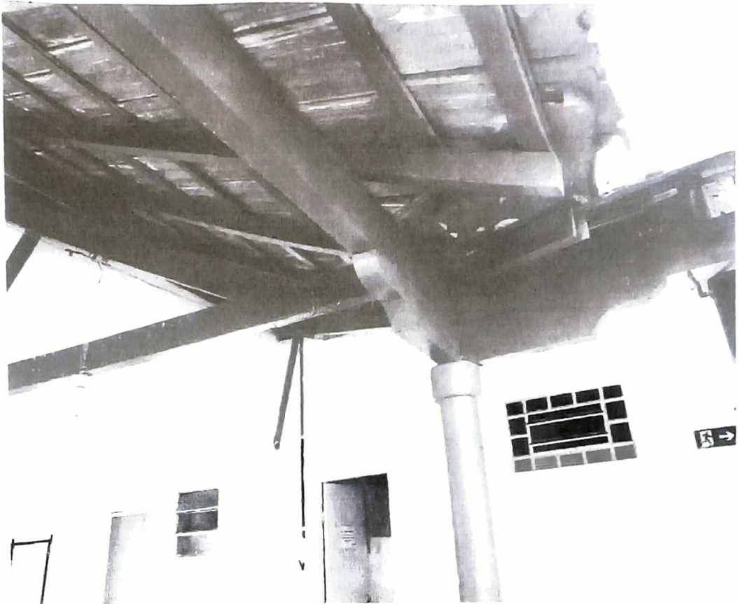
Figura 16 - Cobertura apoiada sob pilar inadequado.
