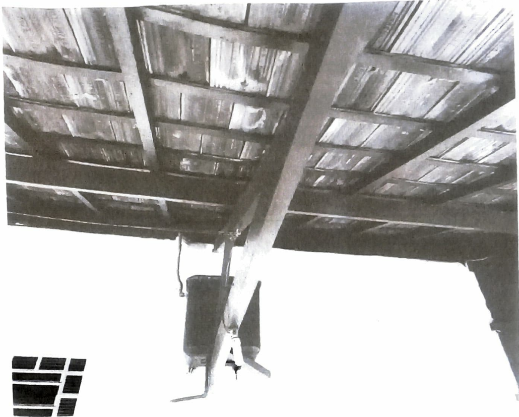
Figura 1 - Peça da estrutura de madeira partida e envergando
