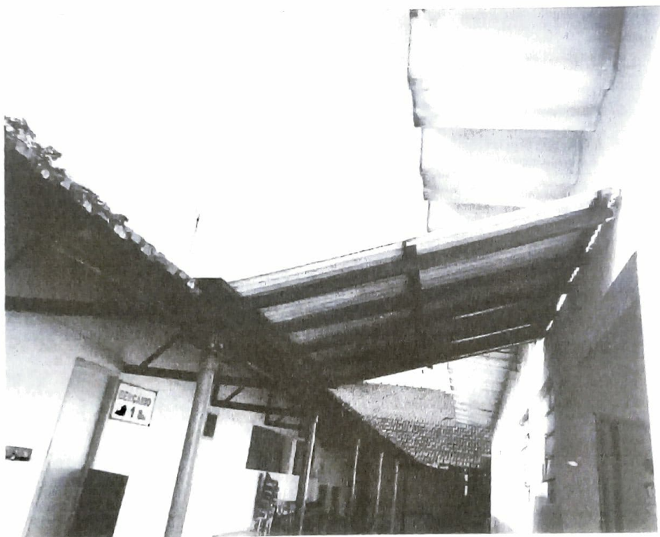
Figura 15 - Estrutura improvisada e executada de forma incorreta, trazendo risco aos usuários
